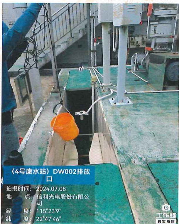
DW002（4号废水站）
