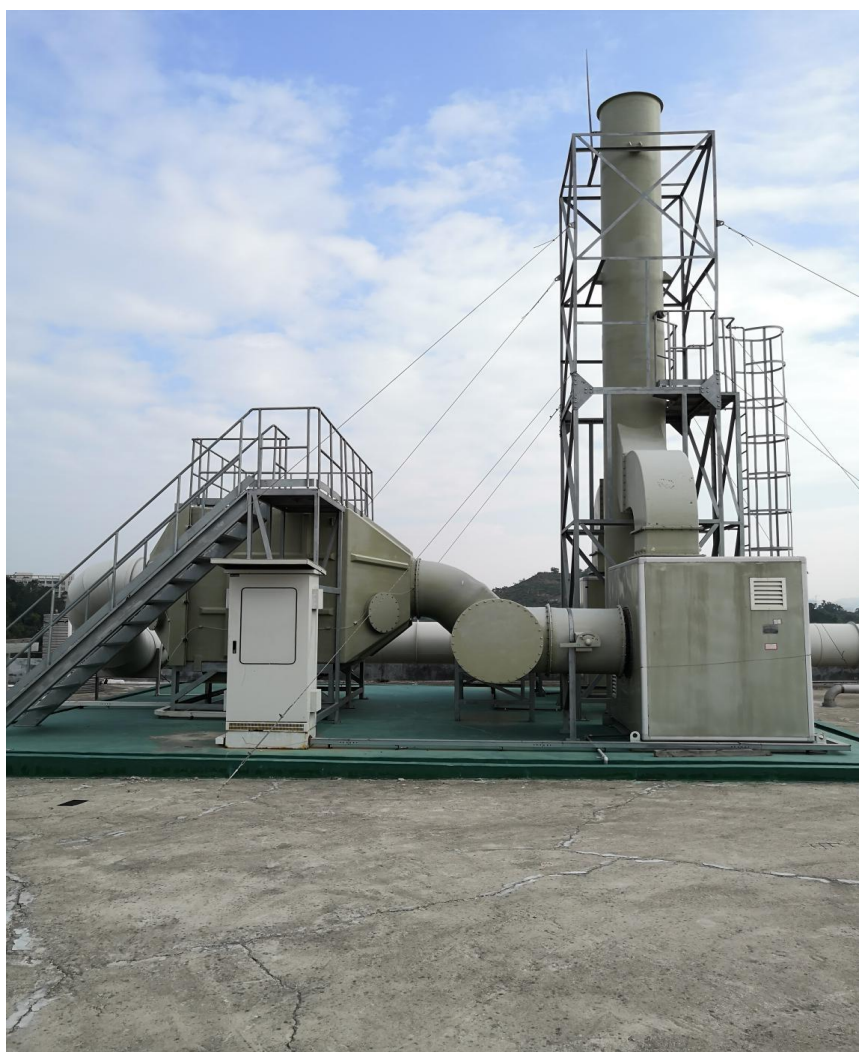
有机废气处理设施
