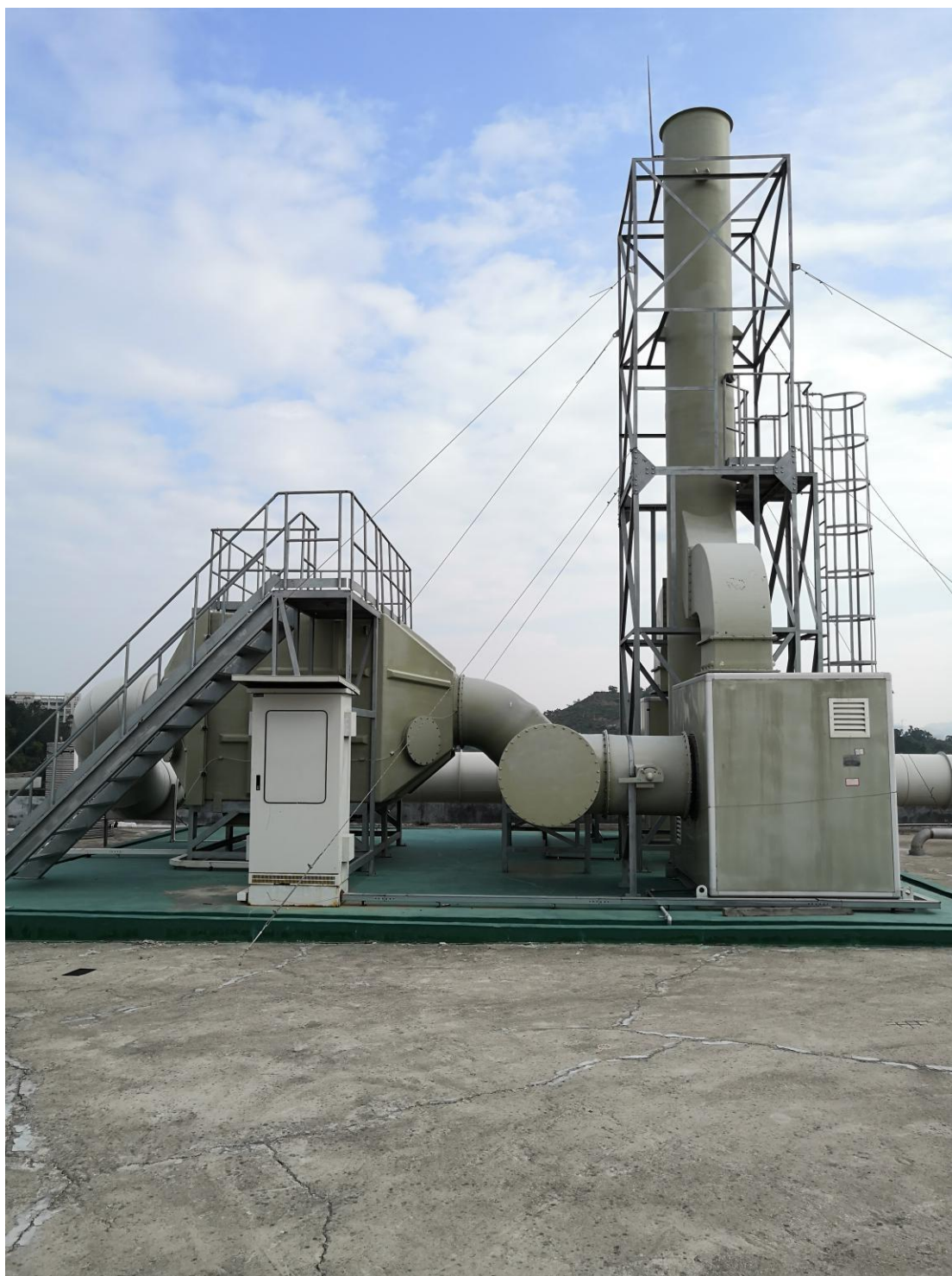
有机废气处理设施
